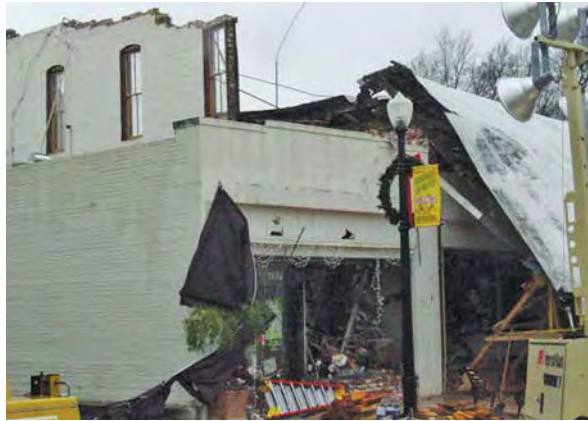
Mái nhà ở phố chánh Paso Robles bị sập sau trận động đất San Simeon, ngày 22 tháng 12 năm 2003. Hai người bị vật rơi đè lên chết khi họ đang chạy ra khỏi tòa nhà. (USGS photo)
