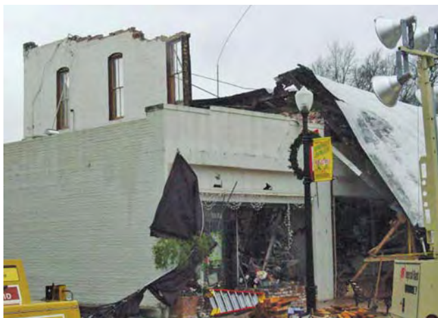
2003年12月22日 San Simeon 地震之后 Paso Robles 市中心的倒塌屋顶。两个人从建筑物向外跑时被掉下的碎片砸死。(USGS photo)
