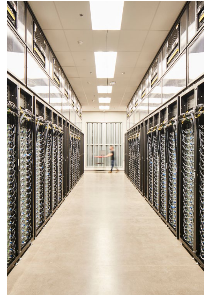
Le data center de Reno, ouvert par Apple en 2012, profite de la douceur du climat en refroidissant ses serveurs avec de l'air extérieur dès que cela est possible.
